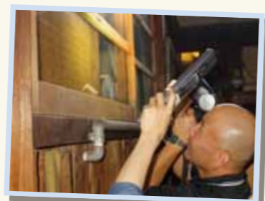
町家調査時の様子。小さな痕跡から、建築当初の姿を探ります。
