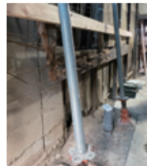
(写真1) 蟻害などの傷みが見られる箇所
